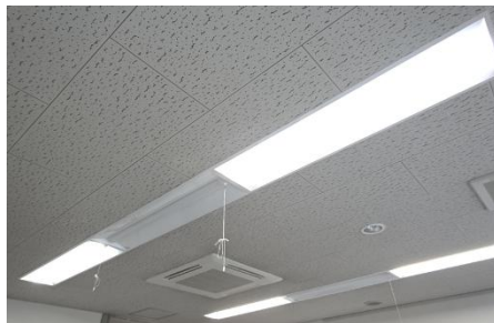
照明のLED化・引き紐で節電
